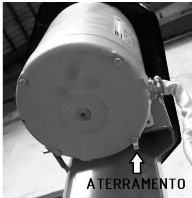
Ponto de aterramento do motor
